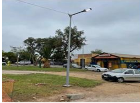
Fotografía 20. Instalación 05 Postes con Luminarias Led, costado plaza en Calle Los Maquis.
